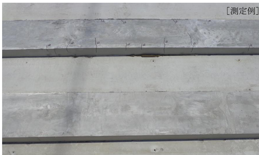
Fig.6. 試験供試体 1 ヶ月間暴露（下；デンカクロルフィックス GV、 上；市販無収縮モルタル）
