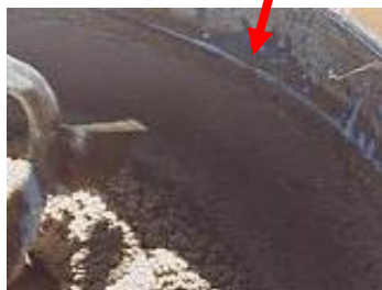
不完全な練混ぜ状態
